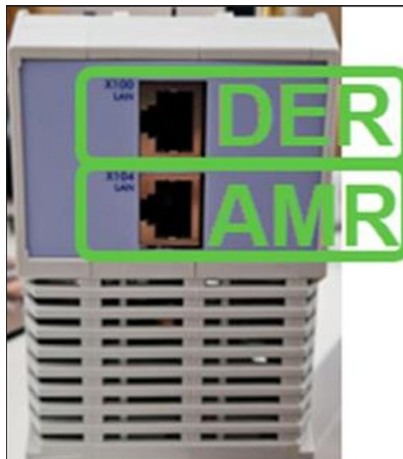
Aansluiting op RTU generatie 5E: onderzijde
